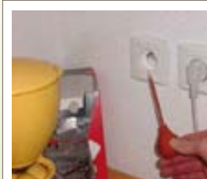
Fuites parasites sur les prises électriques mises en évidence à la caméra infra-rouge
